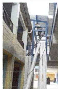
Foto 2: Sustracción de canales PVC.
