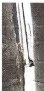
Foto 3: Sustracción de tubería lineal principal.
